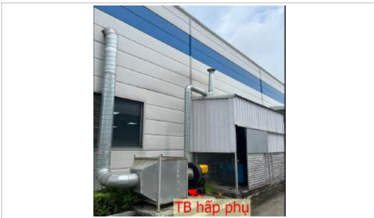
Hình 17. Hệ thống xử lý khí thải của dự án
