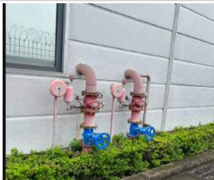
Hình 18. Hệ thống PCCC của dự án
